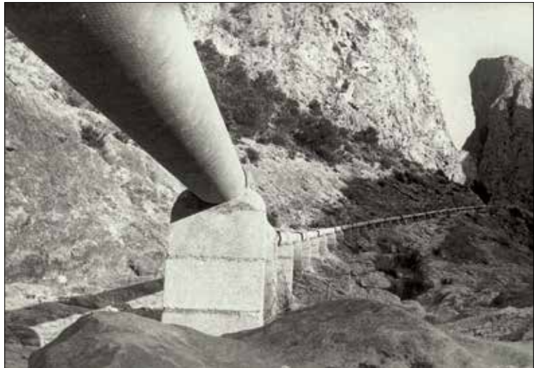
Canalización de agua Barranc del Cint.
