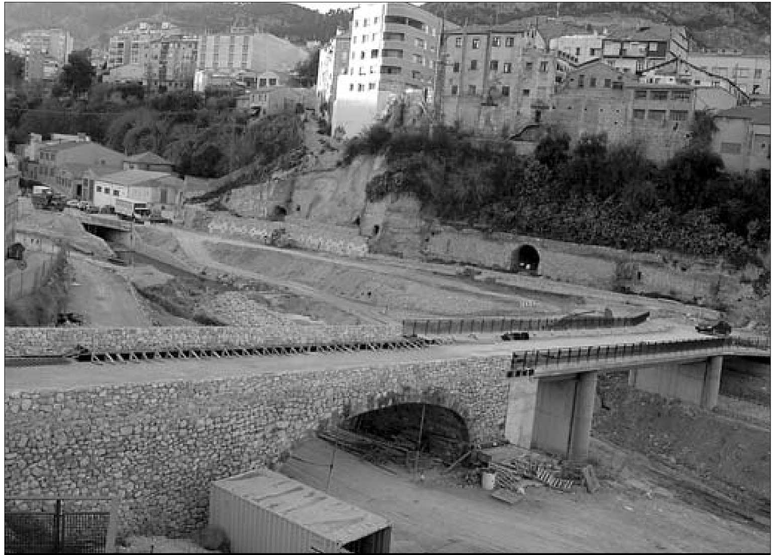
Está previsto que en el plazo de un mes se abra al tráfico el vial del Camino Viejo y el puente de Sant Roc.
