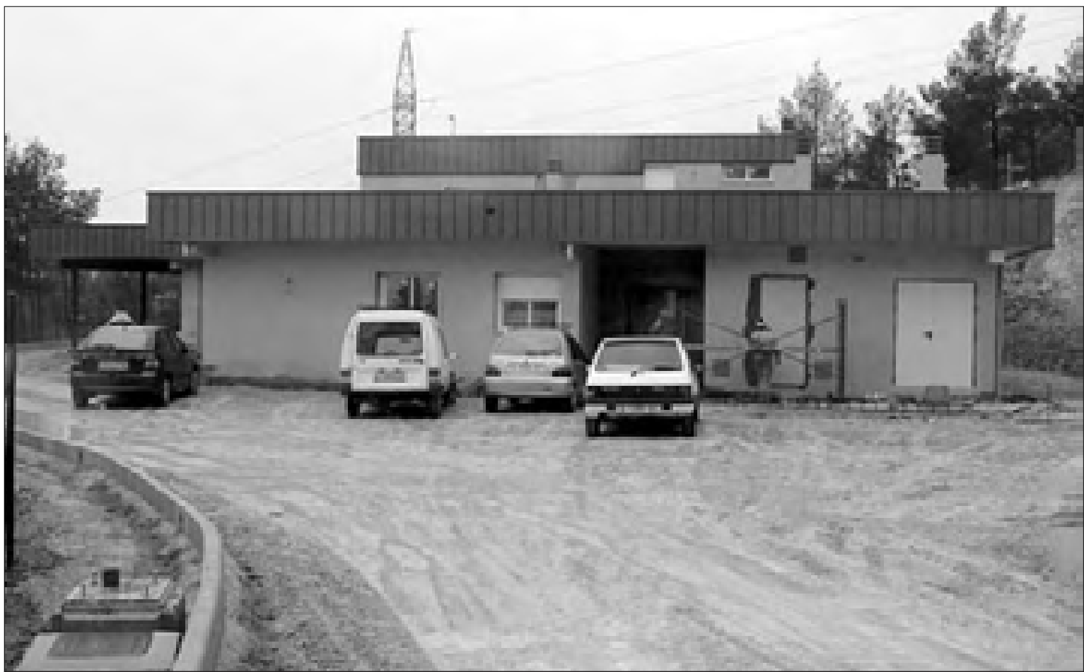
Las obras en el centro de respiro se han intensificado para que dé servicio este verano.
