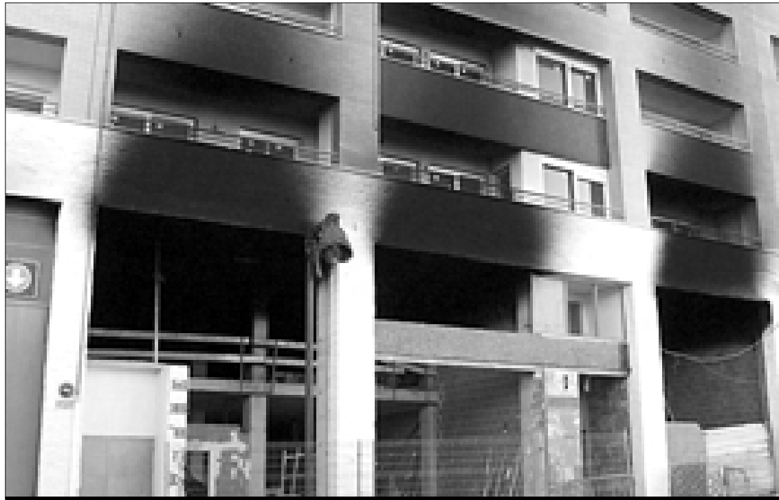
La fachada ha quedado seriamente dañado por efecto del fuego y del humo.
